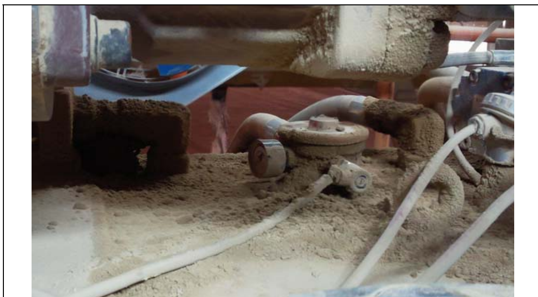
عدم رعایت تمیزی محیط نصب یونیت هیدرولیک و خارج نمودن کارتریج فیلتر برگشت
